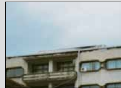
Сл. 1. Тетовската клиничка болница по срушувањето на покривот (во најгорниот дел на фасадата се забележуваат траги од опожарување),
