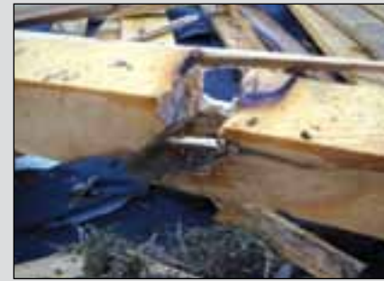
Сл. 10. Грешки со повеќе недозволиви грешки, глужд од 1/3 од напречниот пресек и преоѓа низ целиот пресек, девијација, смолни џебови како и трулеж.
