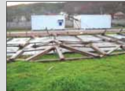
Сл. 5. Срушено-летната решеткаста кровна конструкција од основното училиште во Трапчин-Дол
