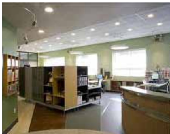
Сл. 8 Осветлување на работна просторија со LED
