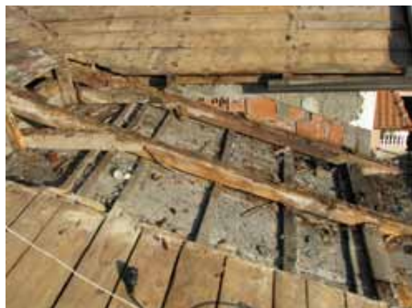
Покривна конструкција уништена од дејство на влага
