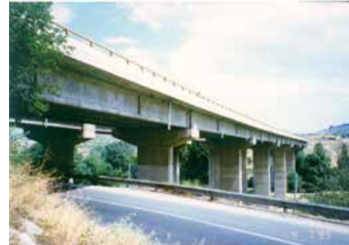
Слика 6.1. Типична конструкција на класична мостовска конструкција. Мост преку реката Вардар (автопат во Македонија)
