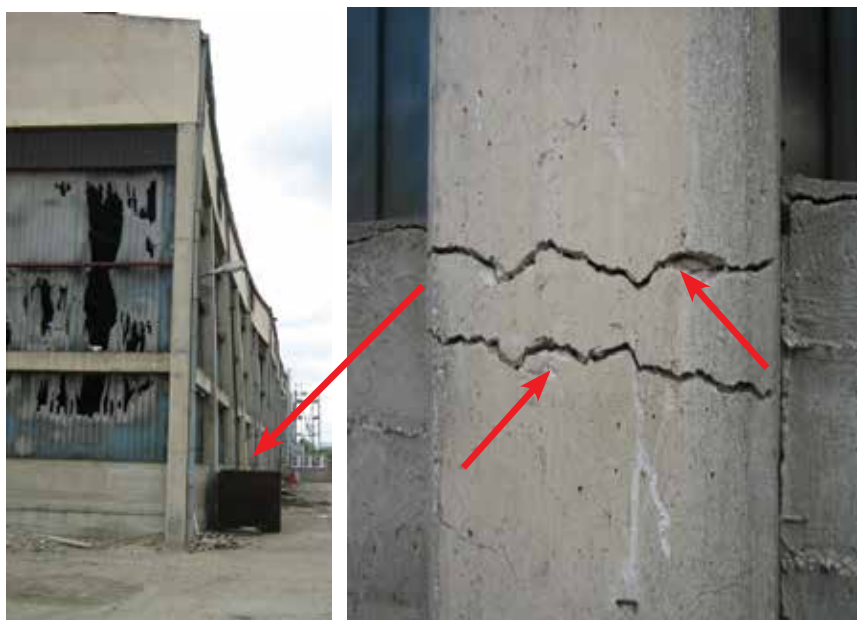
Слика 6: Колапс на АБ столбови од опожарена конструкција
