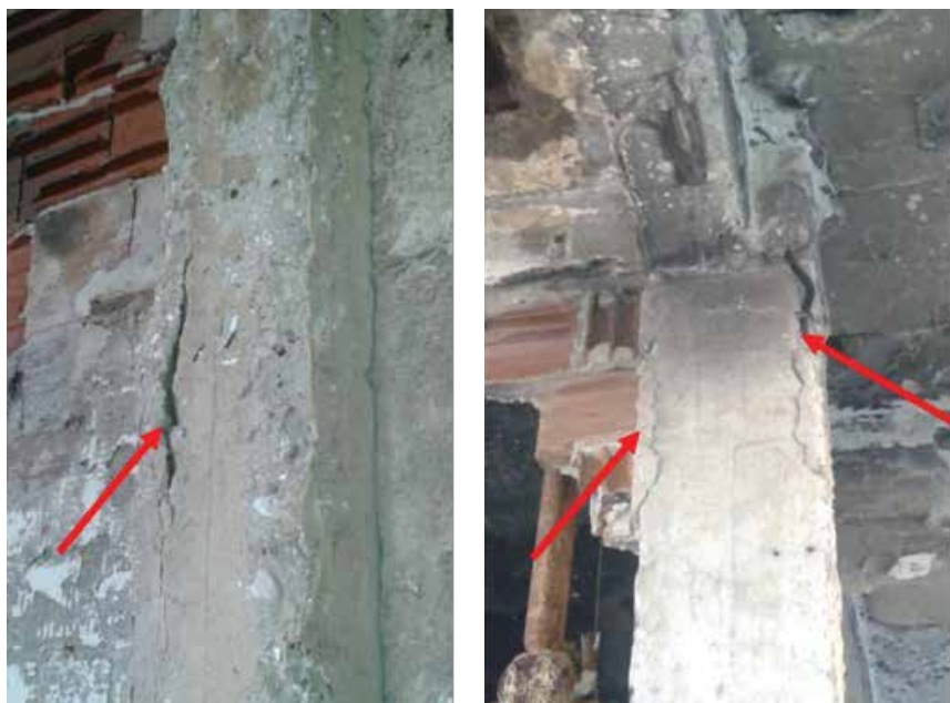
Слика 7: Оштетувања на АБ столбови од опожарена конструкција
