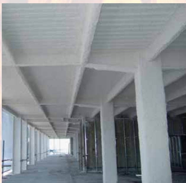
ПП-заштита на челична конструкција и меѓукатна од трапезен лим со противпожарен малтер
